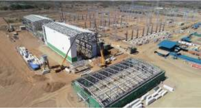
肯尼亚西门子高压输变电站
